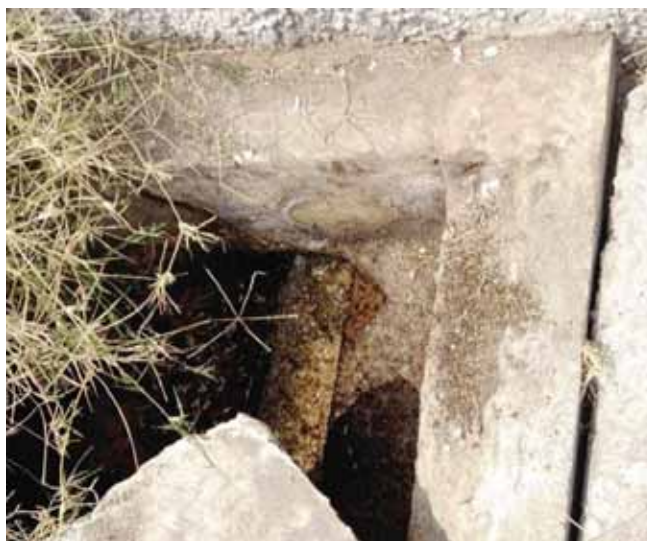
Salida letrinas del baño del internado masculino.
