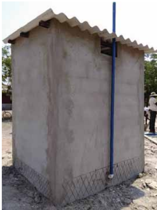
Tubo de ventilación de una de las letrinas.
