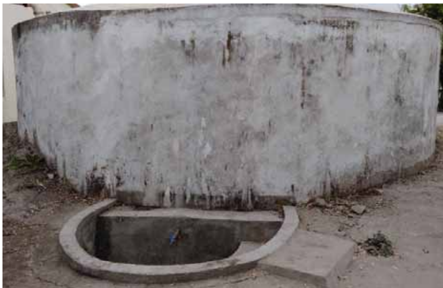
Imágenes del Captador de Agua de Lluvia.
