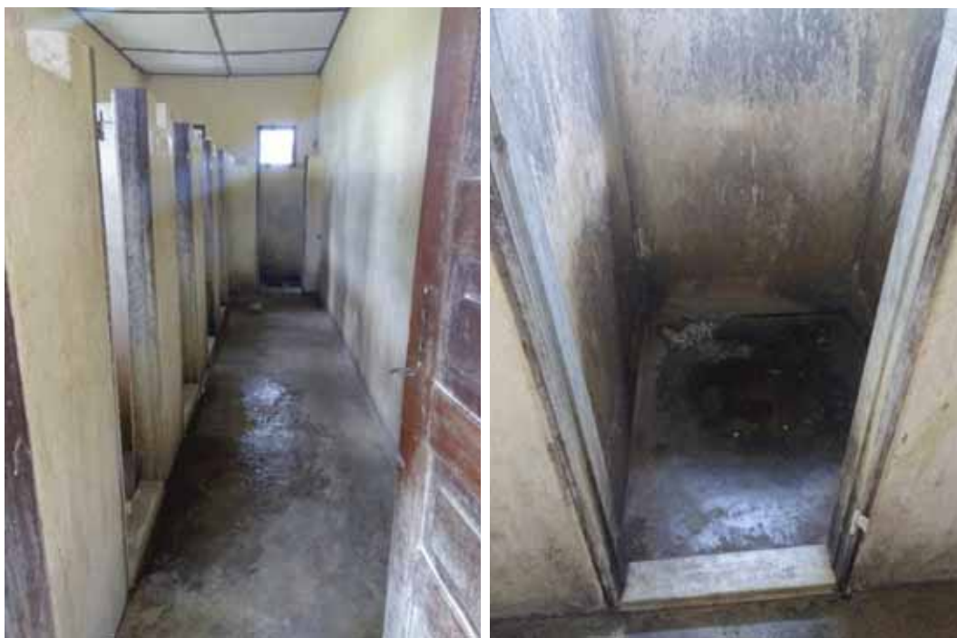
Estado de los baños 1.
