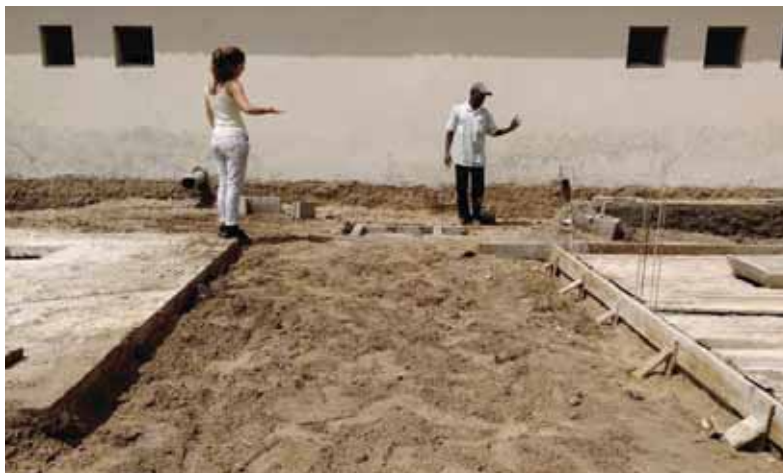
Caja separadora en el centro y ambas fosas a cada lado.
