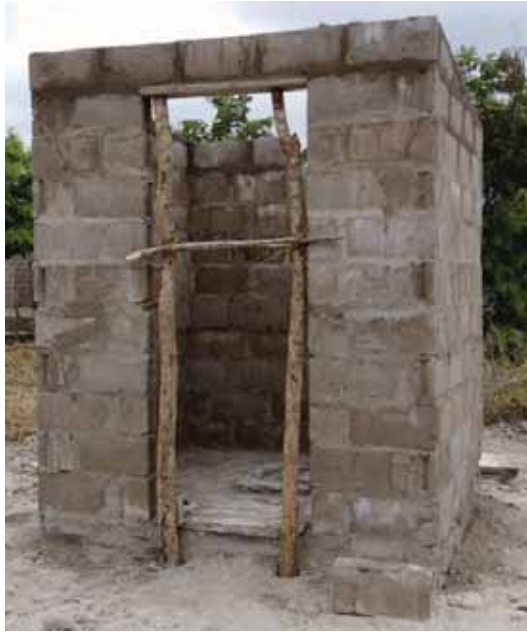
Estado de una de las dos letrinas.
