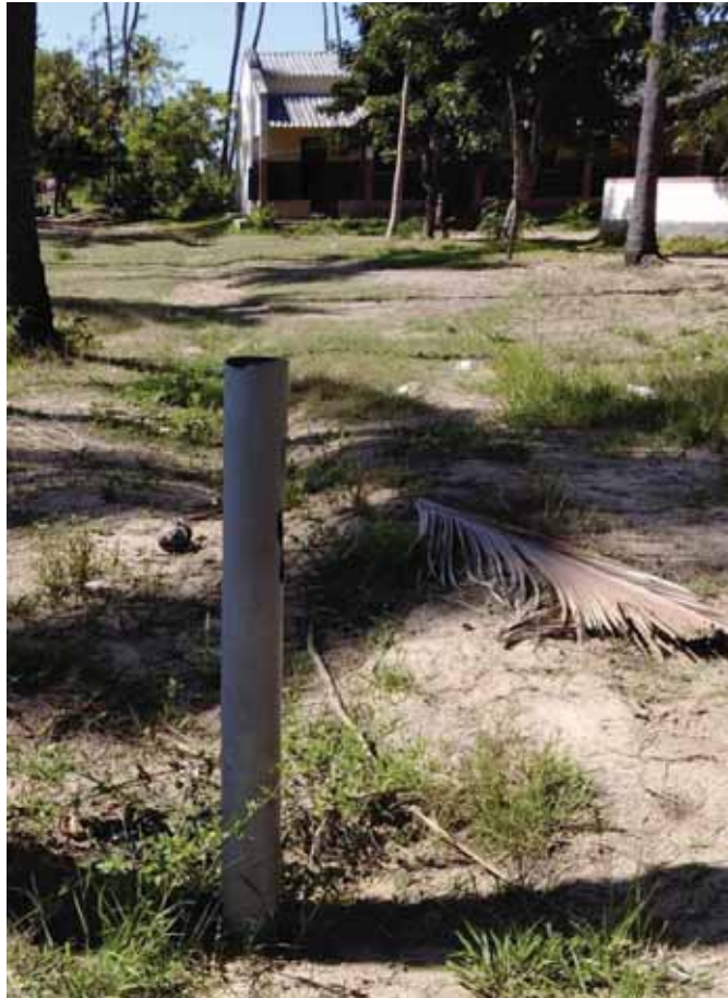
Canalización de desagüe, respiradero (baño 1 en la construcción del fondo, a la dcha. sin aparecer en la foto, se encuentra el baño 2).
