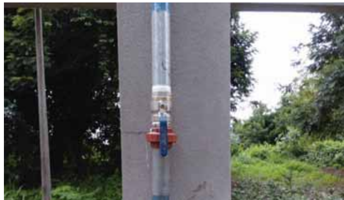
Lave de paso de la bajante.
