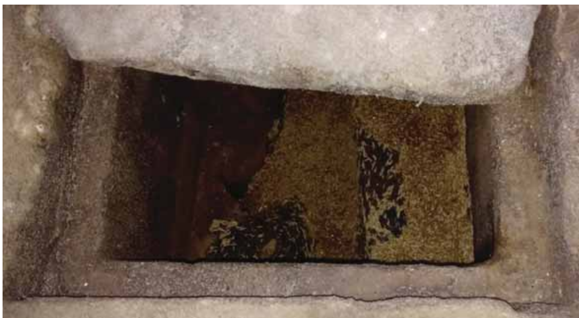
Arqueta situada en el interior de los baños.
