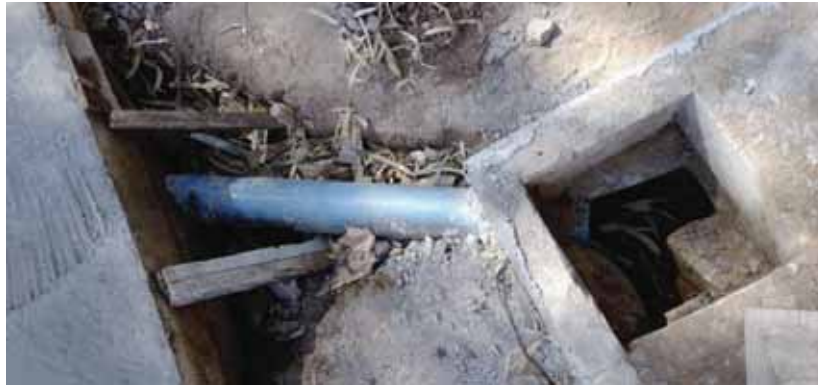
Salida de las arquetas a la fosa de las letrinas.
