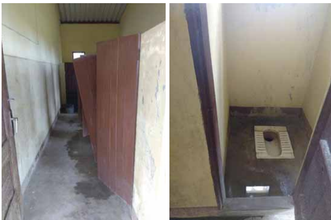
Estado de los baños 2.
